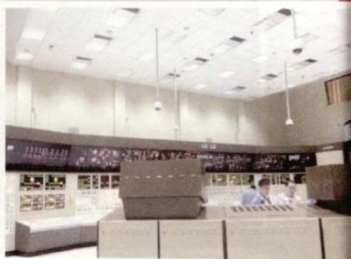
ห้องควบคุมจำลองใช้สำหรับฝึกฝน
