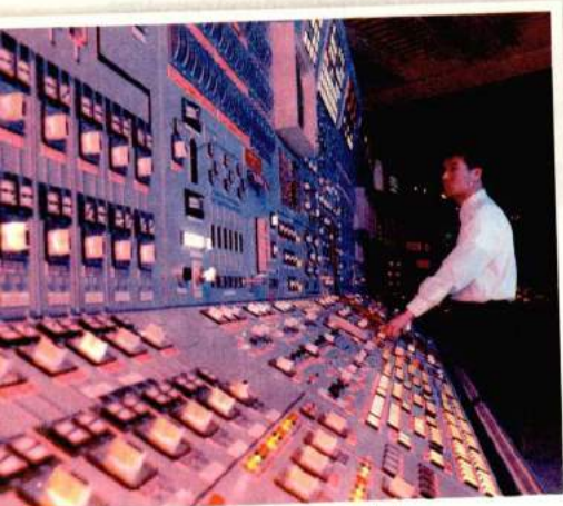
ห้องควบคุมจำลองของโรงไฟฟ้า
