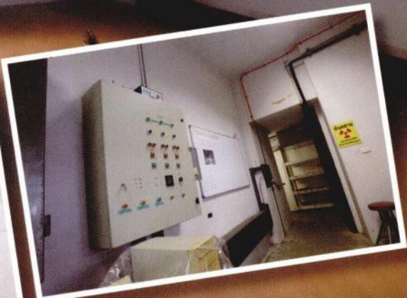
ภายในศูนย์บริการฉายรังสีแกมมาฯ ม. เกษตรศาสตร์
