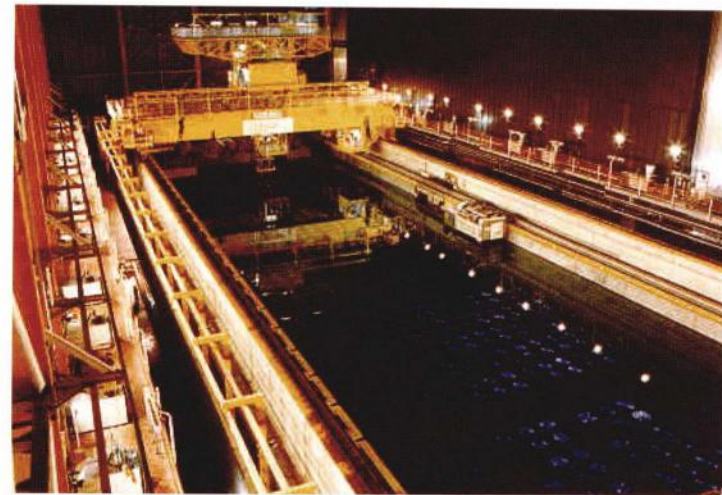
บ่อเก็บเชื้อเพลิงนิวเคลียร์ใช้แล้ว (ที่มา : www.world-nuclear.org )
