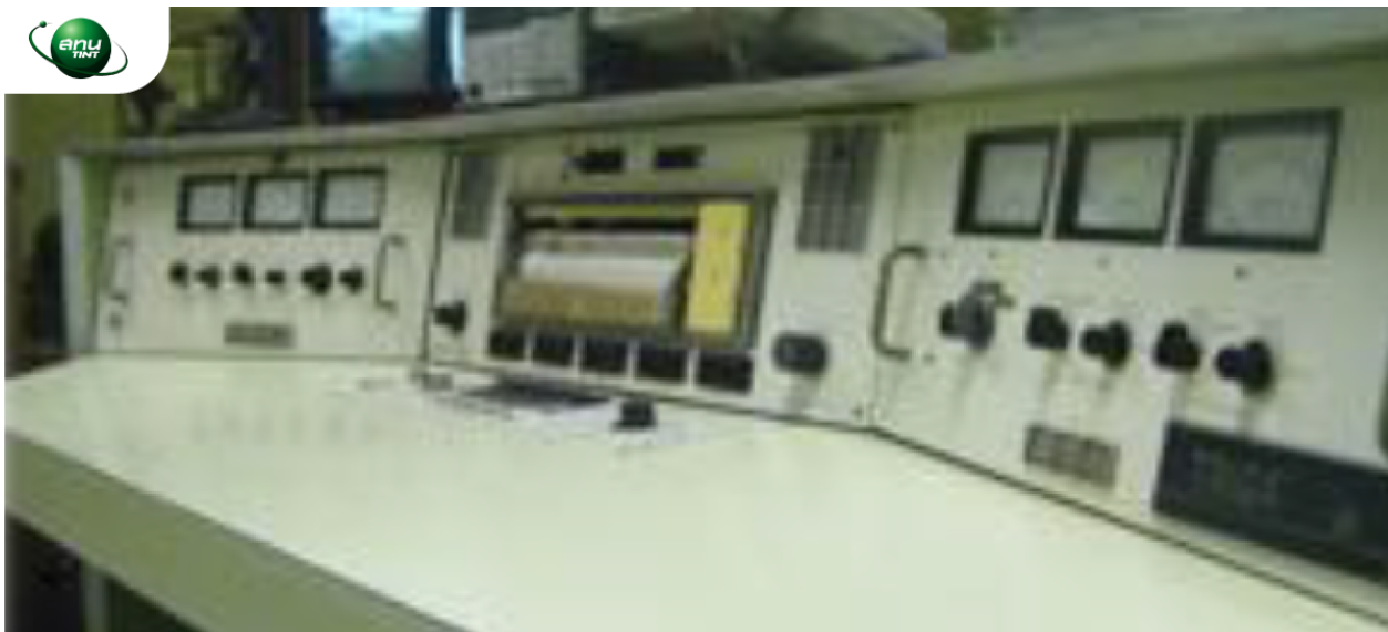
แผงควบคุมเครื่องปฏิกรณ์ฯ ปปว.-1/1 (เก่า)
