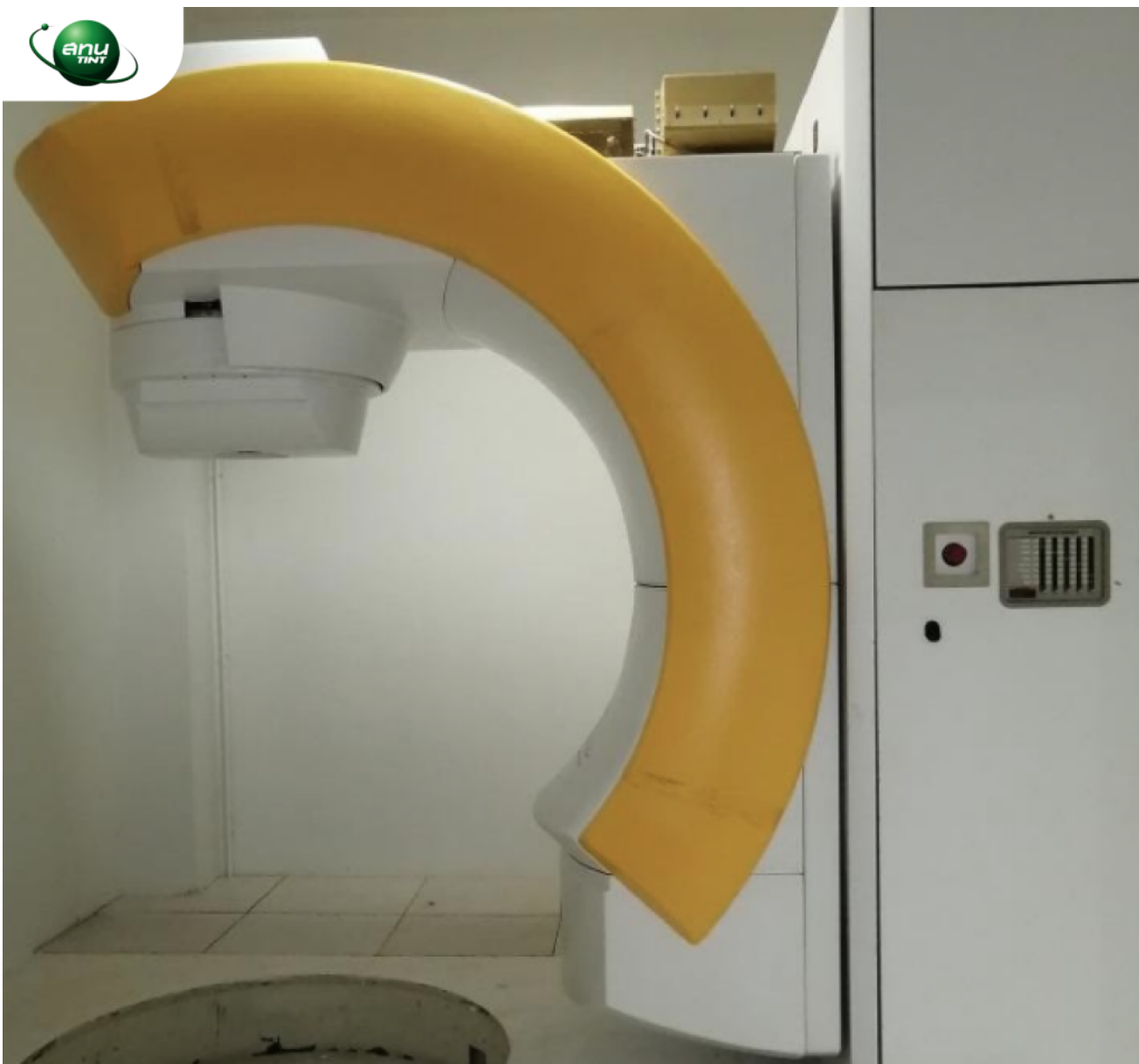
เครื่องเร่งอนุภาคติดตั้งห้องใต้ดินอาคาร 14 สทท.องครักษ์
